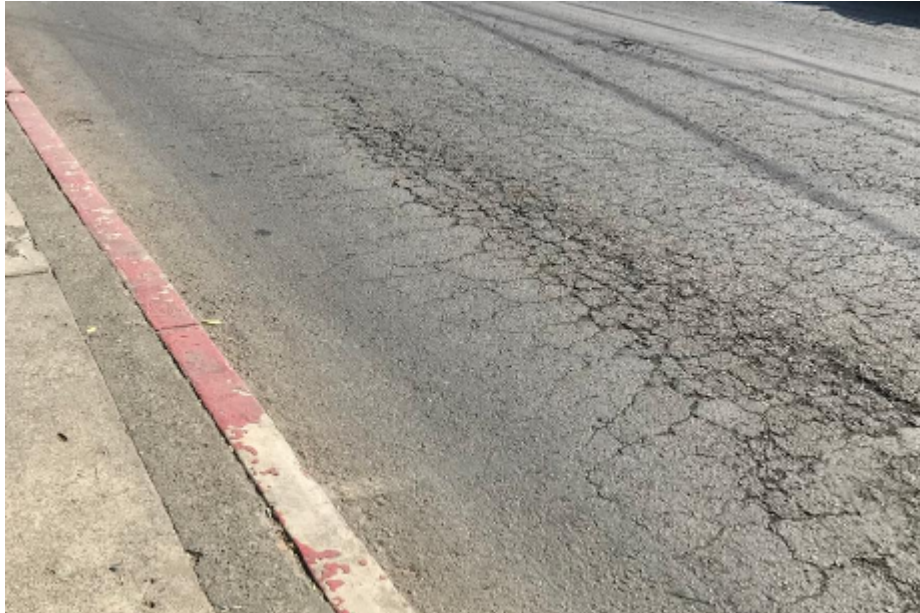
Fig. 1. Ejemplo de avería tipo piel de cocodrilo en asfalto, en esta figura se muestra un conjunto de grietas acumuladas en el pavimento que asemejan la piel de reptil.
